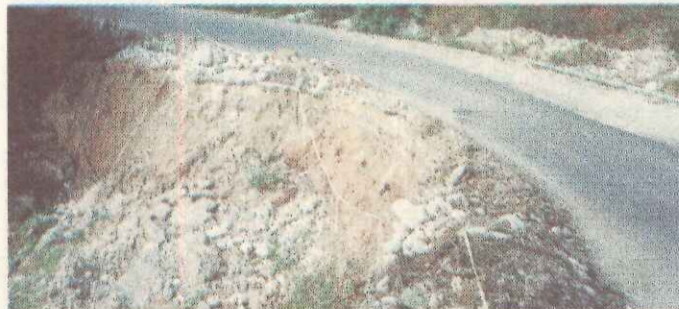
Προβλήματα κατολισθήσεων στο οδικό δίκτυο Γόμφων Μουζακίου και Αργιθέας (φωτό Πευκόφυτο)
