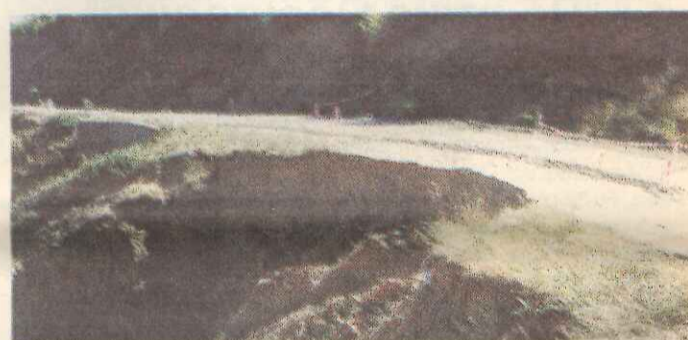
Λίαν επικίνδυνη κατολίσθηση στον δρόμο μεγάλης κυκλοφορίας από Μοσχάτο προς Λίμνη Πλαστήρα.
