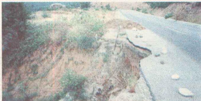
Πέντε επικίνδυνες κατολισθήσεις υπάρχουν στον οδικό άξονα Λουτροπηγής - Ρεντίνας - Ζαχαράκη.
